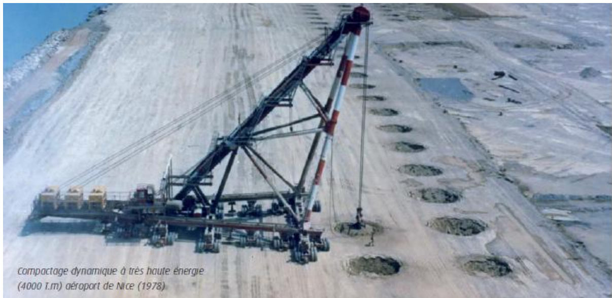
Fig. 1.7 — Densification d'un terrain par compactage dynamique (cas réel de l'aéroport de Nice 1978, France).
